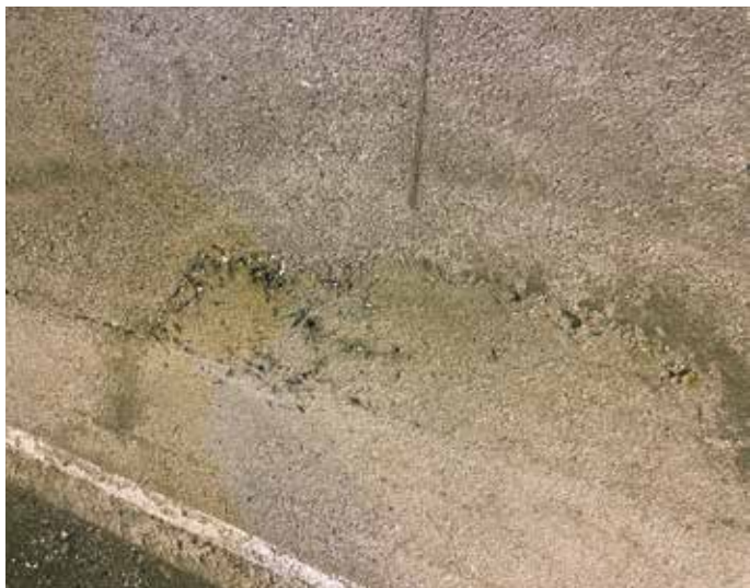
1. Un esempio del grado di porosità del calcestruzzo
