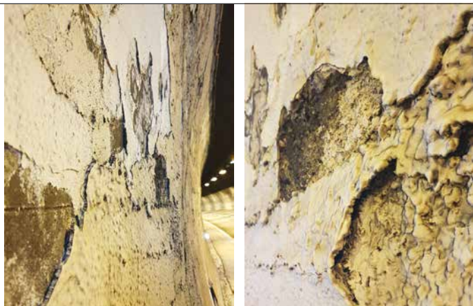
2A e 2B. Materiale in fase di distacco alla galleria Sessarego
